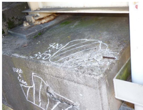
写真 4 橋台のうき・剥離・鉄筋露出(Ⅲ判定)
