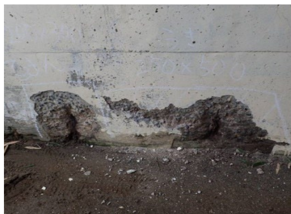
写真 2 側壁の剥離・鉄筋露出(Ⅲ判定)
