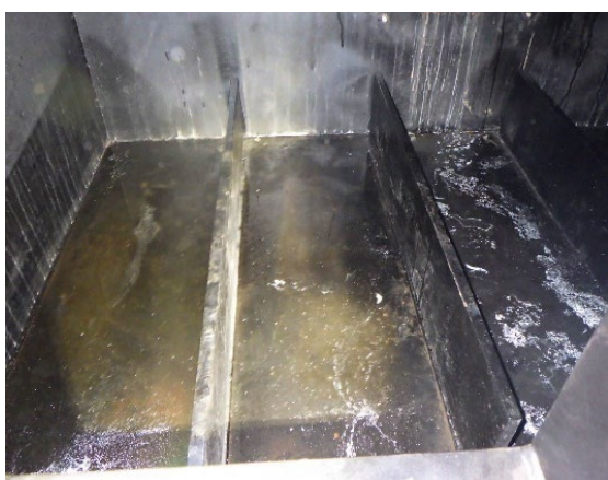
写真 3 橋脚梁部(内部)の漏水・滞水(Ⅲ判定)
