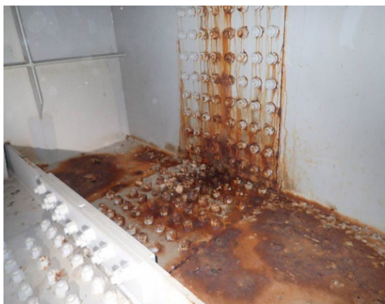
写真 1 主桁(箱桁内部)の腐食(Ⅲ判定)
