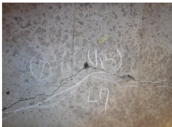
写真 2 覆工のひびわれ（Ⅱ判定）
