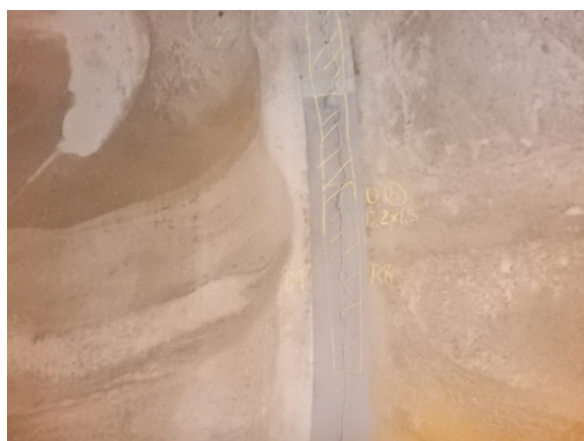
写真 3 補修材のうき（Ⅱ判定）
