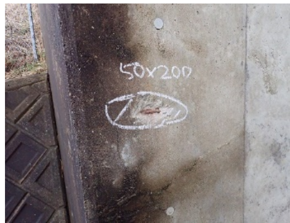
写真 4 側壁の剥離・鉄筋露出(Ⅱ判定)
