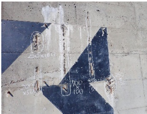
写真 3 側壁の剥離・鉄筋露出(Ⅱ判定)
