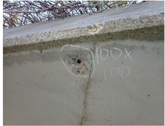
写真 2 頂版の剥離・鉄筋露出(Ⅱ判定)
