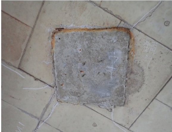
写真 1 頂版の補修部のうき・錆汁(Ⅲ判定)
