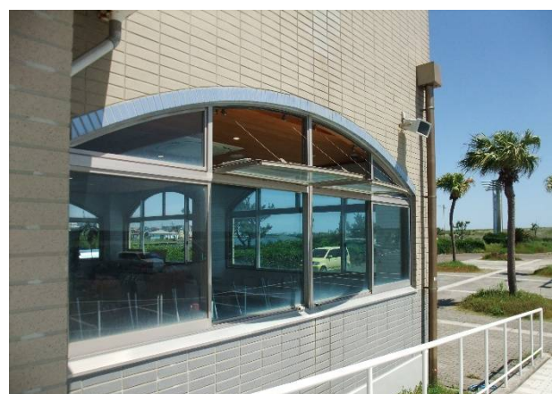
休憩所施設の換気
